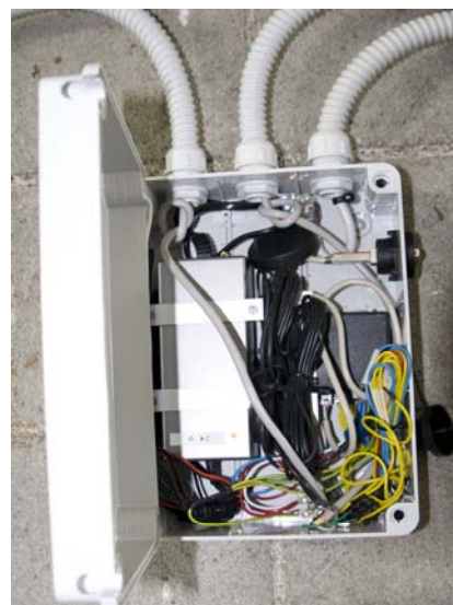
Cablaggio del sistema di acquisizione dati
